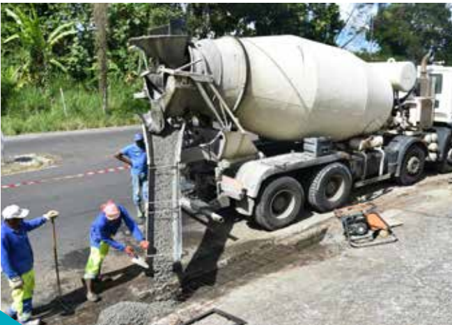
Réfection des grilles de canalisation à l'intersection de la RN1 et de la voie communale de Augrain Sud et Nord
